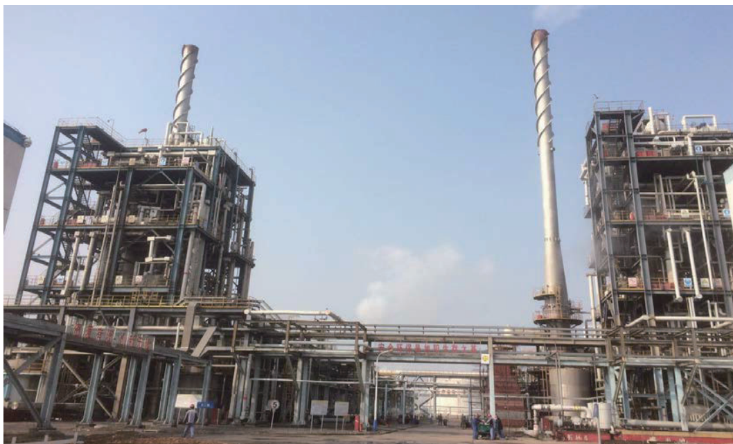
唐山生產園區的苯酐生產設施
